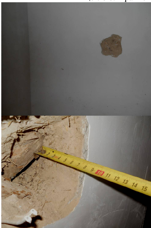
Фото 18, 19. Вигляд внутрішньої поверхні зовнішніх стін старої частини будинку.
