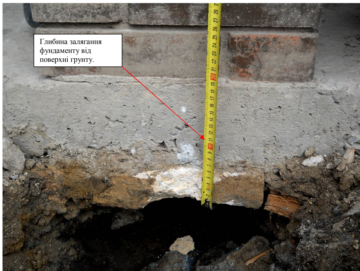
Фото 10. Шурф № 1. Глибина залягання фундаменту під цегляну колону складає 100 мм.
