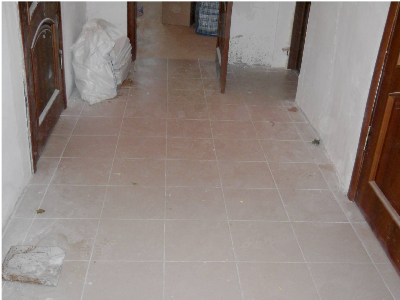
Фото 26, 27. Вигляд підлоги з керамічної плитки першого поверху.
